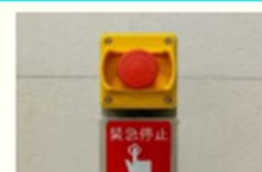
緊急停止ボタン
